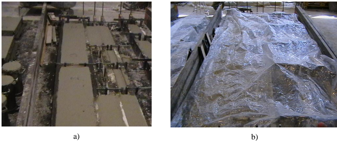
Figura 3.15. (a) Corpos-de-prova após a concretagem, antes de serem cobertos com plástico (b) Corpos-de-prova cobertos com plástico.
